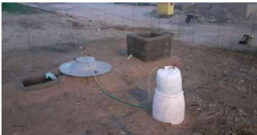
صورة 1 : وحدة المفاعل الحيوي ( الهاضم اللاهوائي )
